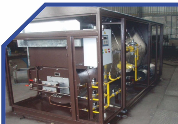
Модернизированное оборудование (2010г)
