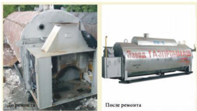
Устаревшее оборудование (1980г)
